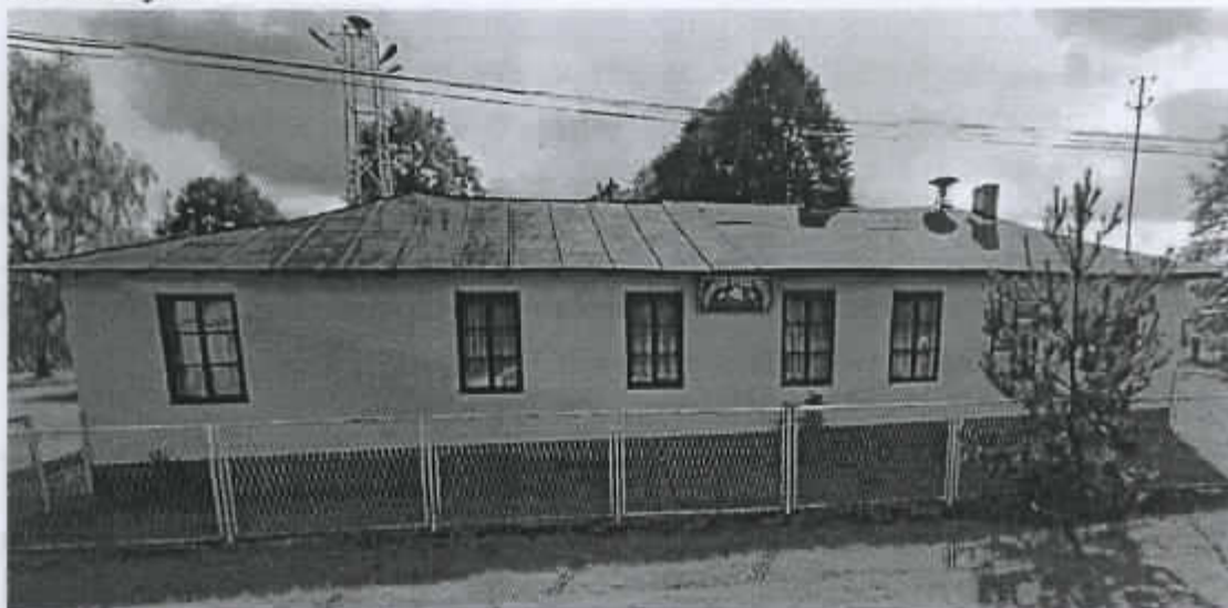
Fot. Widoczne znaczne ugięcia połaci dachu ( elewacja frontowa )
